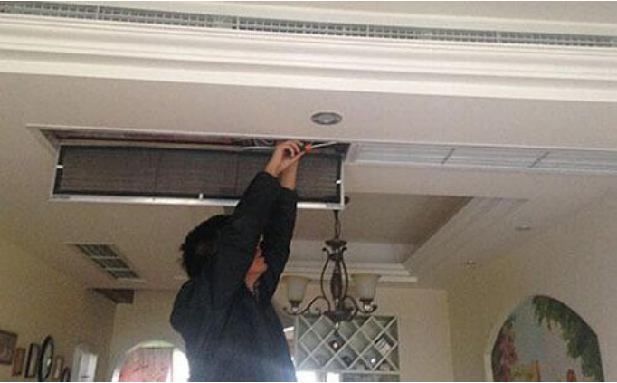
▲回风口常被用作维修口
